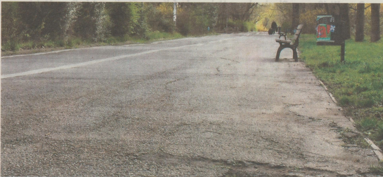
Marode Promenade im Mühlenkiez. Sie soll bis 2026 erneuert werden. Die Vorplanungen laufen. Foto: Bernd Wähner
